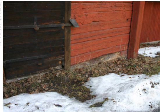
Röta i syllstock på uthusbyggnaden.
