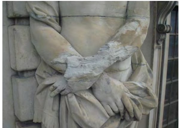
Flera av karyatiderna på Västra längans yttre fasad har omfattande skador. Denna med delvis bortvittrad arm och hand.
