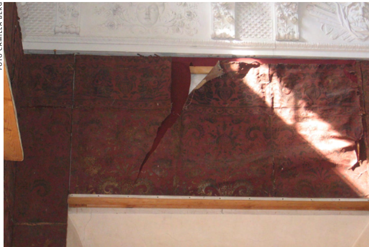
Salsta slott: Direkt solinfall gör att skadorna förvärras och accelererar. Den här revan har uppkommit efter år 2003 då en översyn av interiörerna gjordes.
