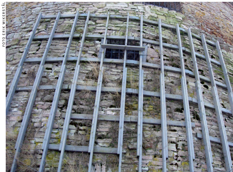
Kalmar slott: En spricka klyver den östra postejen och ett större parti (ca 70m 2 ) av det yttre murskalet har separerat från murkärnan. Murpartiet buktar kraftigt utåt och är nära kollaps. Skadorna har förvärrats av murarnas hårda och oeftergivliga fogbruk. Skalmuren är provisoriskt säkrad med wire och regler.
