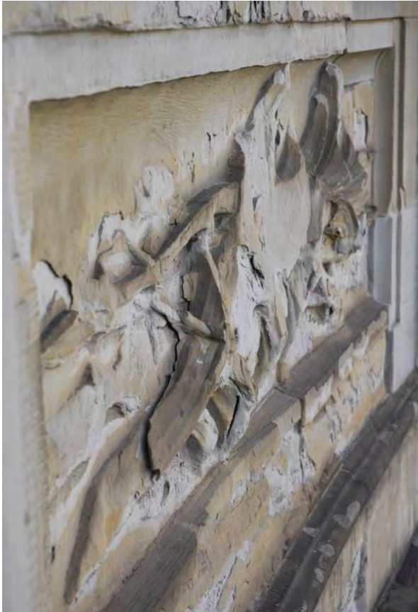
Detalj av skadebild på relieftavla i rundflyglarnas takbalustrad.
