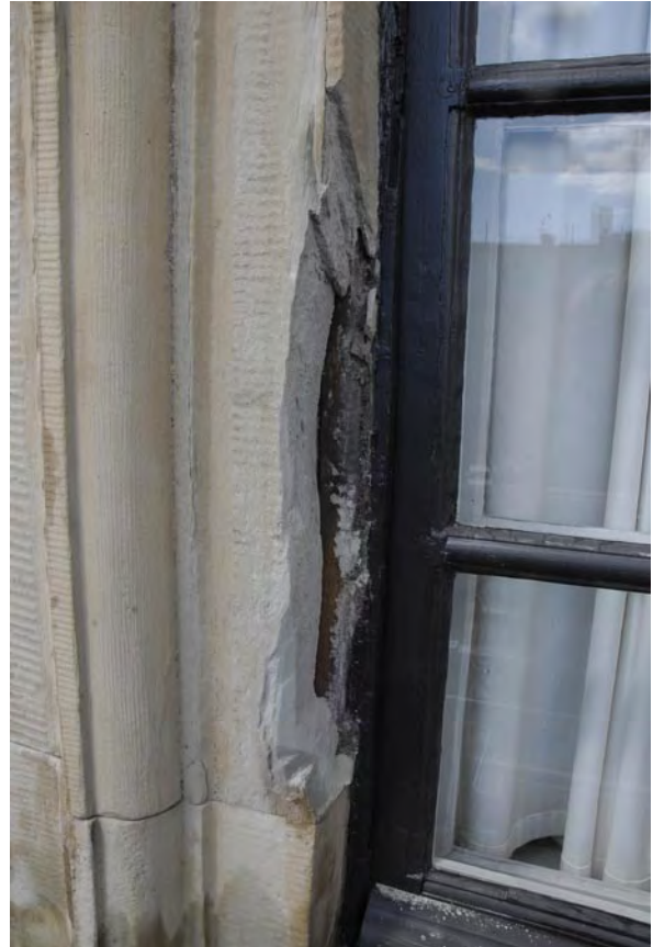
Skada i fönsteromfattning.
