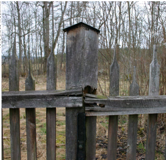
Staketet har angripits av röta och bör bytas ut.
