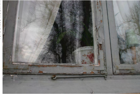
Fönster i behov av ommålning på ekonomibygnadens södra sida.
