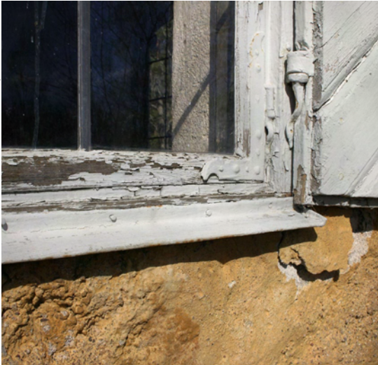
Fönster och fasad i behov av åtgärder på museibygnaden.
