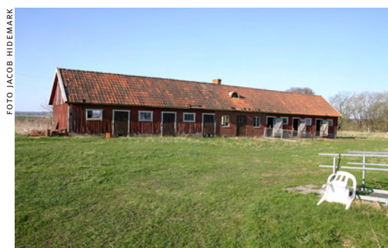
Hönshuset är i stort behov av total upprustning.
