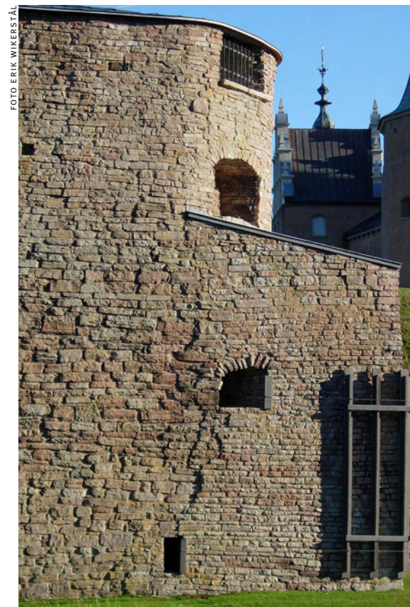
Kalmar slott: Det är okänt när den utvändiga strävpelaren byggdes för att stötta den norra postejens sydvästra hörn. Strävpelaren har idag egna sättsprickor och deformationer. För att dess hörn inte ska kollapsa har det provisoriskt förankrats med wire och regler.
