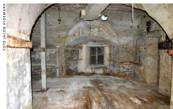
Skadad interiör i norra batteriet.
