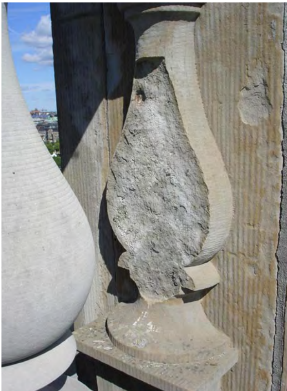
Engagerad balusterdocka i takbalustraden med kraftigt materialbortfall.
