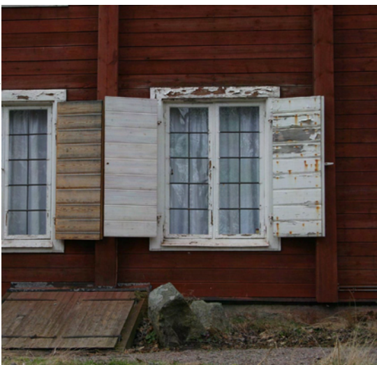
Fönster på huvudbyggnaden i behov underhållsåtgärder.
