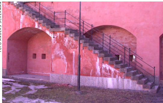
Omfattande puts- och murverksskador i anslutning till trapploppen upp till Slutningsmurens skyttegång.
