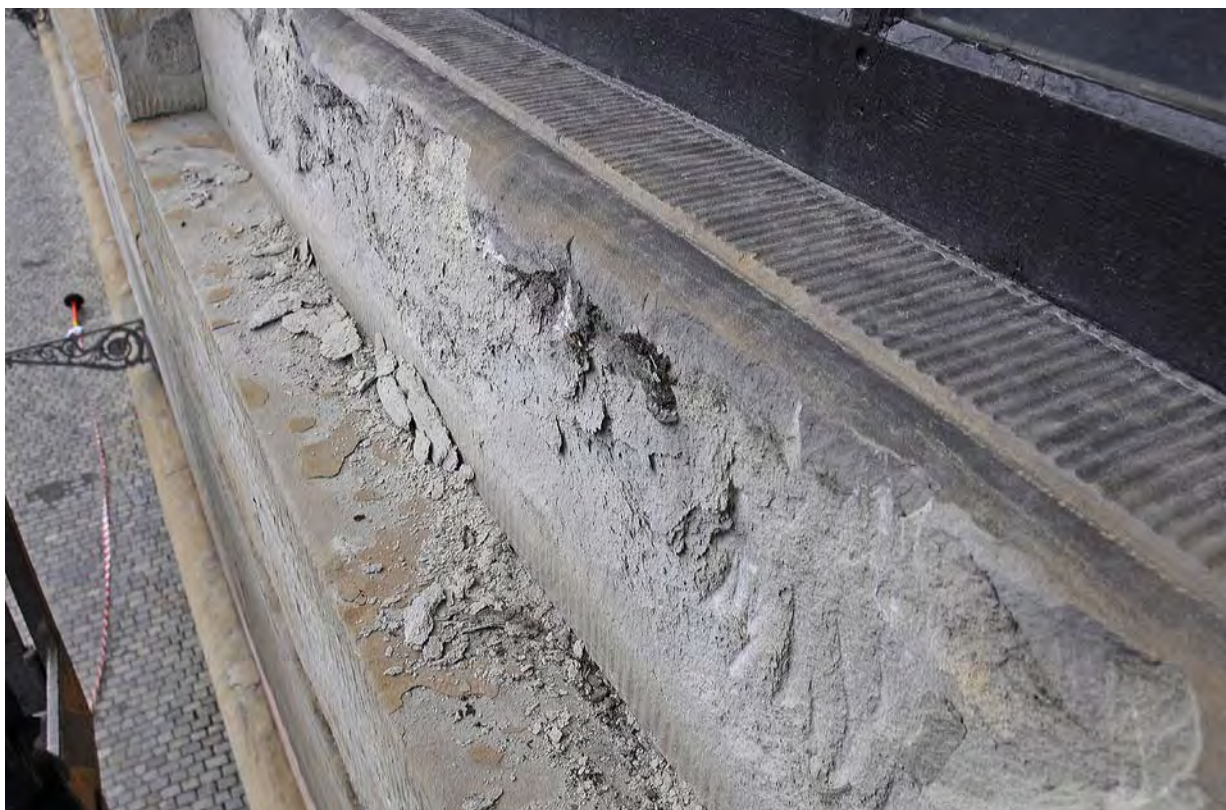
Detalj skada fönsteromfattning
