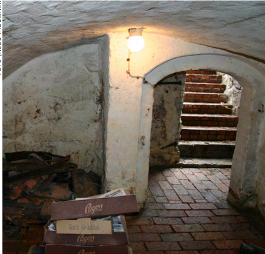
Fuktskador i huvudbyggnadens källare.
