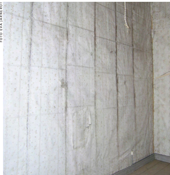
Salsta slott: Klimatproblem i det uppvärmda slottet gör att mögel fått grepp och spridit sig snabbt, till exempel i det här rummet med tapeter från 1700-talet. En koncentration av det svarta möglet finns i limfogarna.
