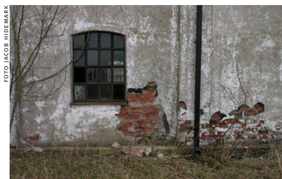
Puts- och tegelskador på magasinets västra fasad.
