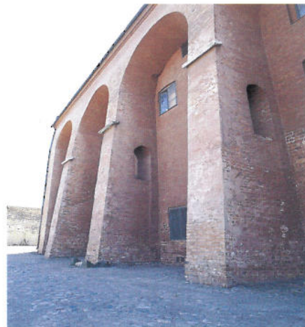
De mäktiga kontreforterna vid huvudlängans borggårdsfasad tillkom för att bära upp det stora bombfria tunnvalv som slogs över byggnaden under 1720-talet. Valvet ersattes på 1830-talet av de nuvarande två valven över byggnaden.
