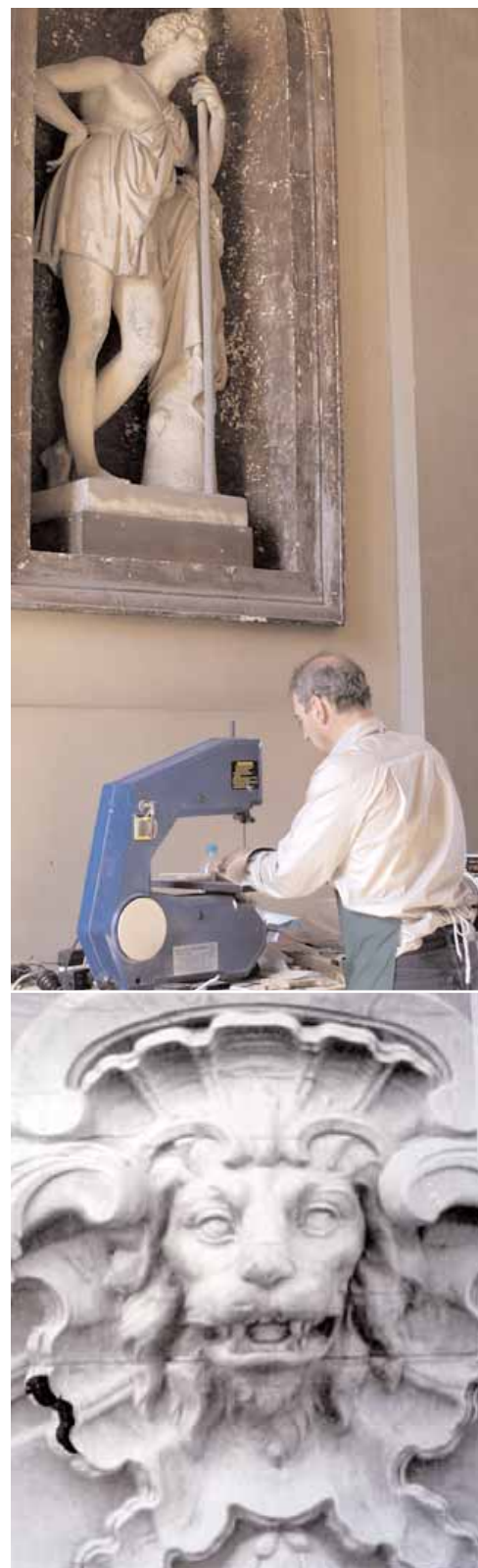
Ovan och ovan t.h. De lossade delarna nålas upp på skalenliga fotografier under arbetets gång för att kunna återmonteras på exakt rätt platser.
